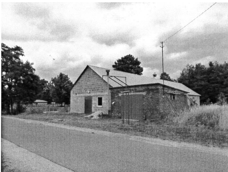
Rysunek nr 26. Dokumentacja fotograficzna – stan techniczny remizy OSP w Kakawie Kolonii
