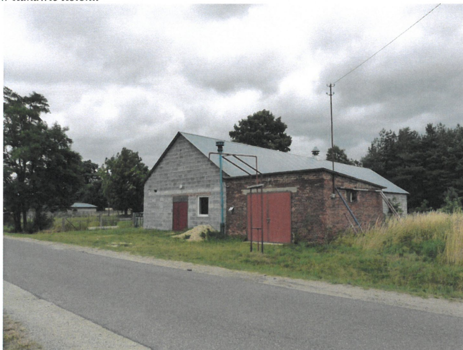
Rysunek nr 38. Dokumentacja fotograficzna – stan techniczny remizy OSP w Kakawie Kolonii
