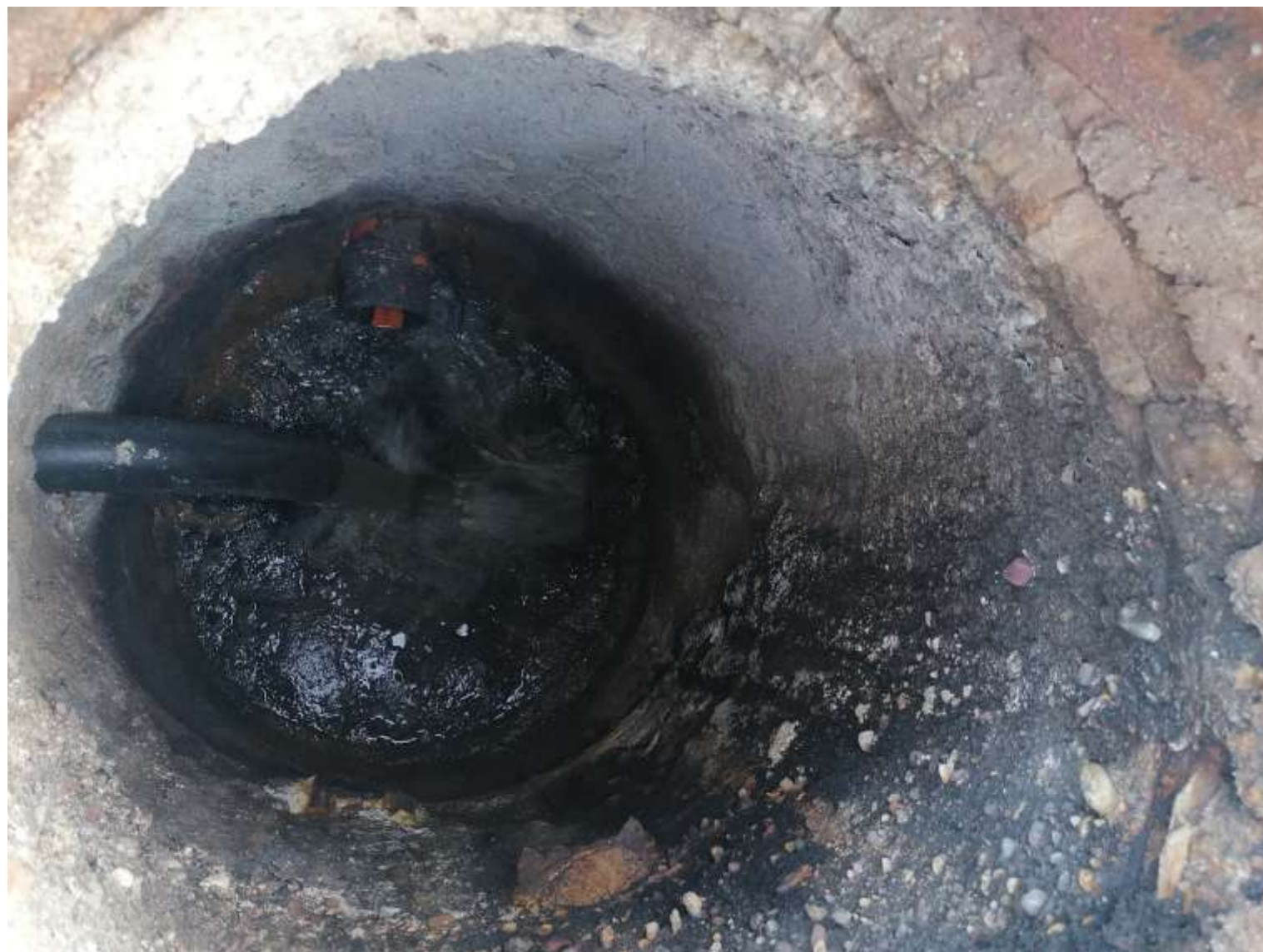
Studnia rozprężna SR1 ul. Marii Konopnickiej przy posesji nr 15
