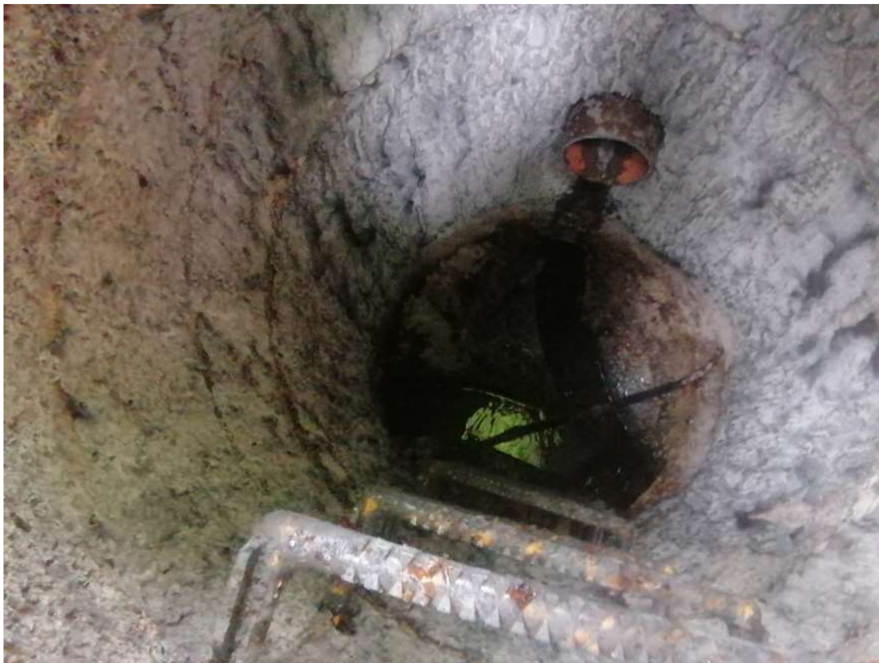
Studnia kanalizacyjna w miejscowości Wolica
